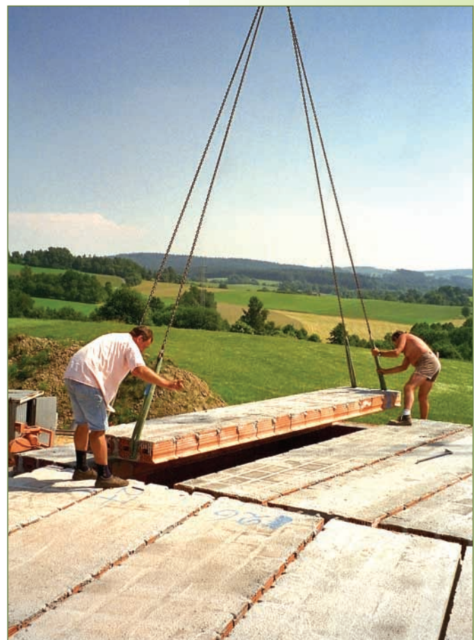
... und können mit dem Kran sofort verlegt werden. In wenigen Stunden entsteht eine komplette, voll belastbare Geschößdecke.
